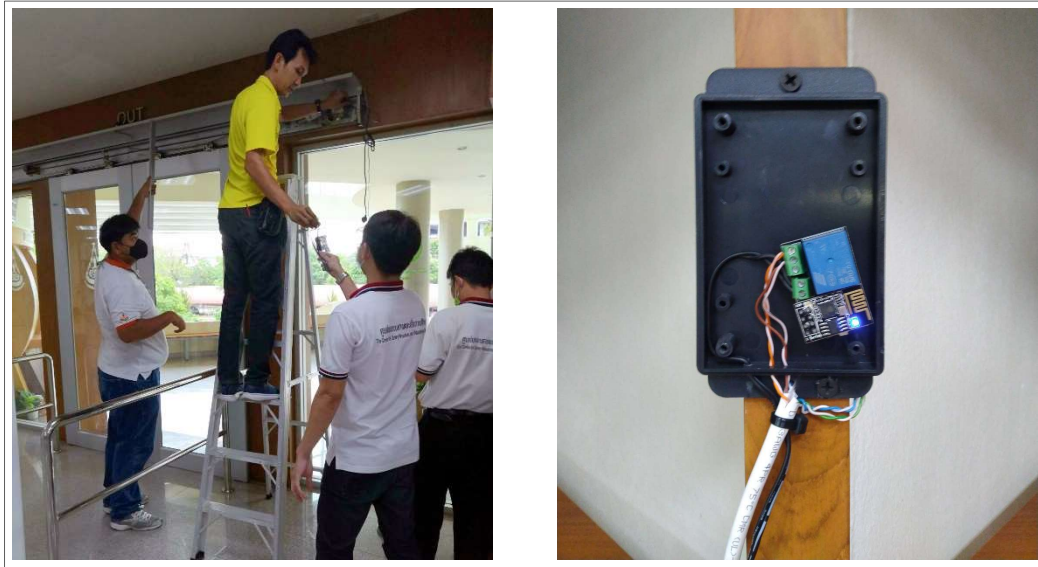
ภาพที่ 8. การติดตั้งอุปกรณ์ IoT ที่ประตูทางออก
